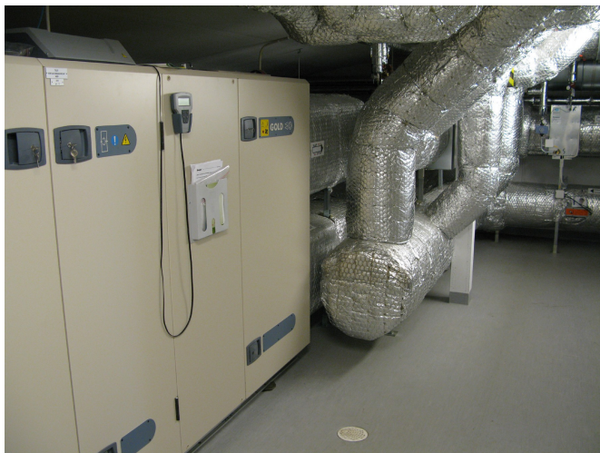
Fläktrummet i Stadsskogens förskola som byggts med passivhusteknik
