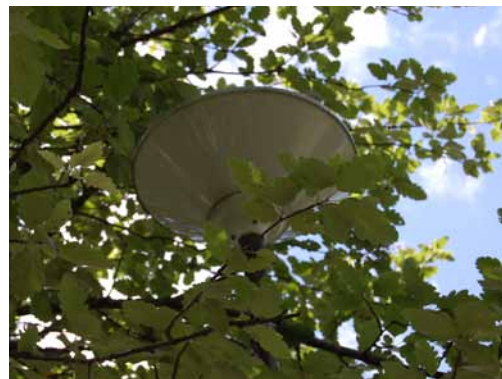
Ljusarmaturen bäddas in av ett vildvuxet träd. Detta gör att belysningen begränsas och att färgåtergivningen försämras då ljuset missfärgas av bladen.
