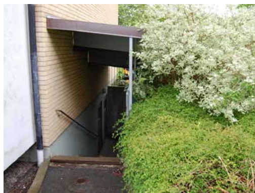
Källartrappans slutenhet gör att det är omöjligt att ta sig därifrån om någon ställer sig i vägen längre upp i trappen. De stora buskagen hindrar ljusinsläpp och gör nedgången mörk.
